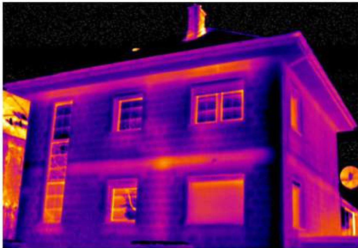
Imatge 9. Termografia a l'hivern d'un habitatge unifamiliar que mostra les zones on es produeixen pèrdues energètiques (vermell). Font: enllaç .
