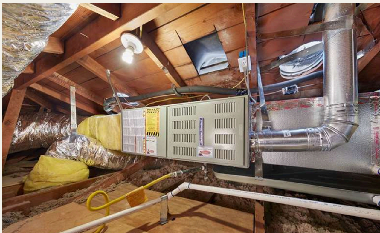
Imatge 10. Instal·lació de climatització a l'espai sota coberta d'una teulada inclinada. Font: enllaç .
