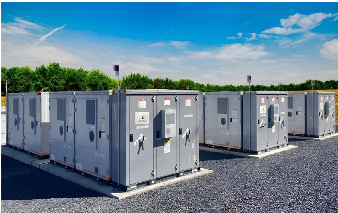
Figura 6. Bateries d'emmagatzematge energètic a Espanya ( Font )
