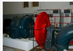
Central hidroelèctrica d'1 MW a Peñafiel (Valladolid).
