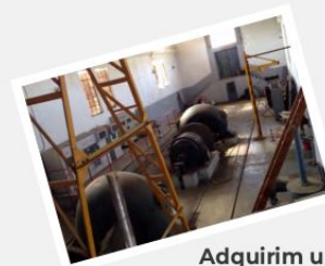
Adquirim una central hidroelèctrica en 2 hores
