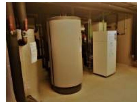
Sala tècnica geotèrmica
