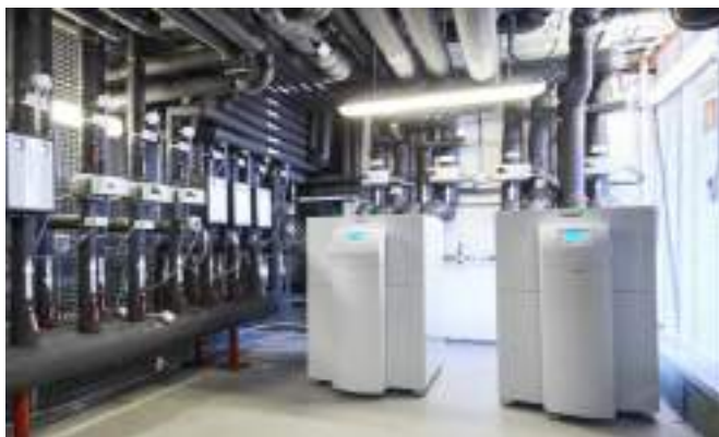
Implementació de la sala tècnica
