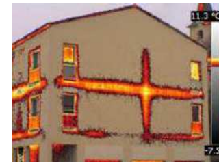
Un pont tèrmic en una façana
