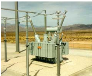
Foto 2– Exemple d'un reactor trifàsic de 400 kV i 160 MVar de dimensions 9x6x9 m i 160 tones de pes. S'estima que es necessitarien de 3 a 4 reactors com aquest per circuit i per subestació d'extremitat. Font: [16]
