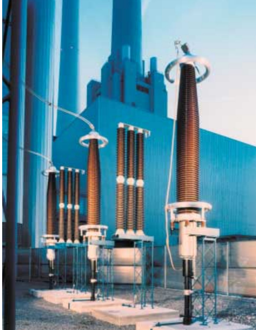
7 El primer sistema europeo de cable XLPE de 400 kV, montado en Altbach (Alemania)
